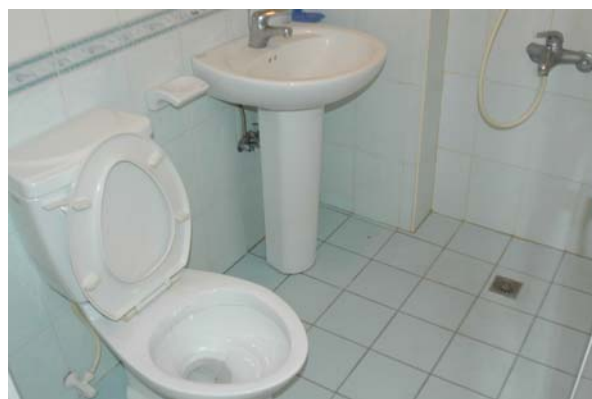
柏德 MBA 學舍套房衛浴設備
