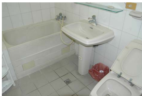
交響曲公寓（1）公共區域-衛浴設備
