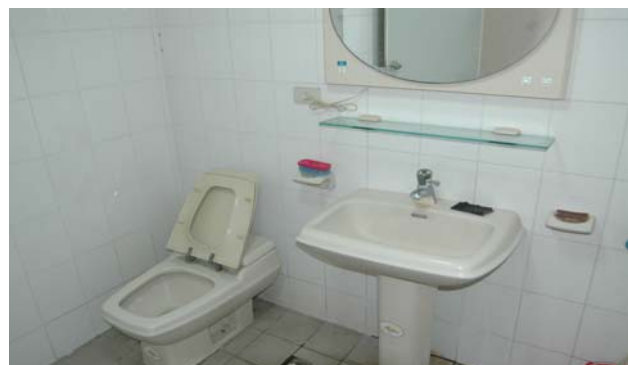
交響曲公寓（1）公共區域-衛浴設備
